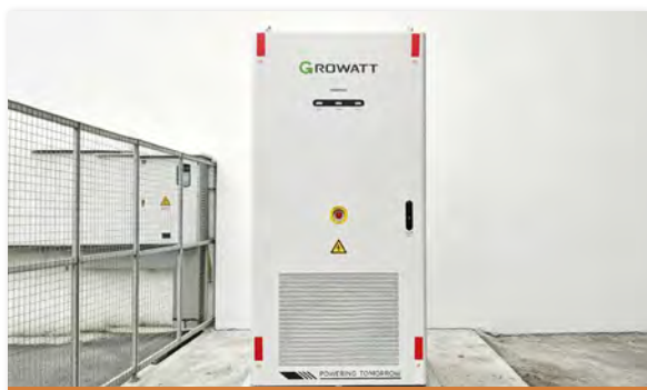
📍 华东充电站储能 储能：261kWh
