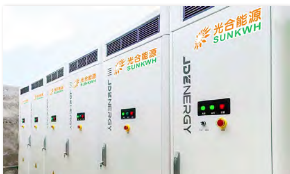
📍 摩彩光储项目 光伏：1039.6kW 储能：1145kWh
