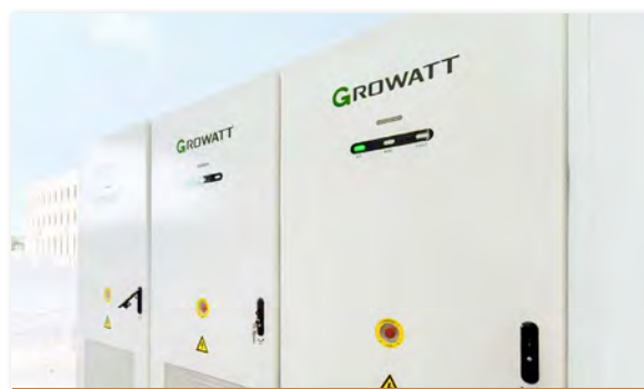
📍 海泰光储项目 光伏：599.68kW 储能：783kWh
